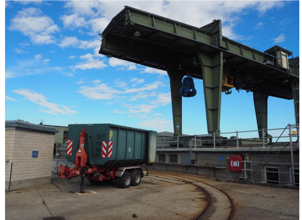
© Conversio: Treibgutsammelcontainer an einem Wasserlaufkraftwerk
